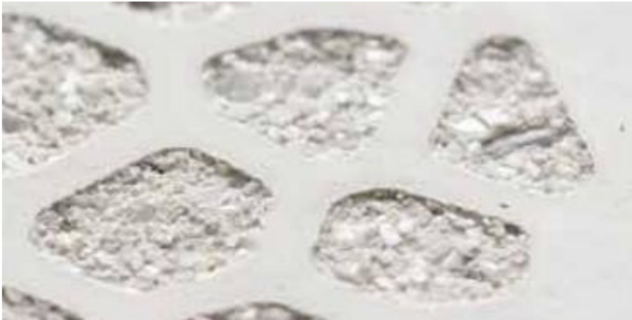
شکل ۲- ریتاردر با تخریب موضعی بتن در لایه سطحی سبب بوجود آمدن الگوی از نقشه در سطح بتن میشود
