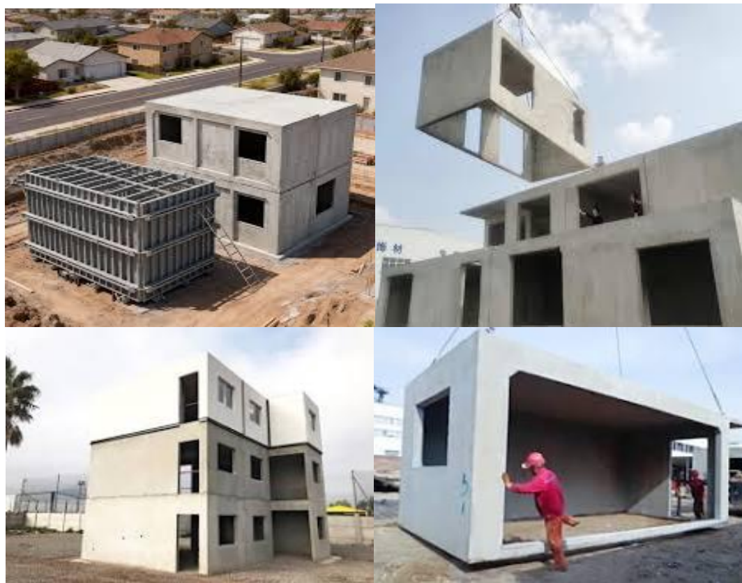
شکل ۱- ساخت سازه های حجمی بتنی پیش ساخته روشی مهندسی و خلاقانه در زمینه تولید انبوه ساختمان می باشد
